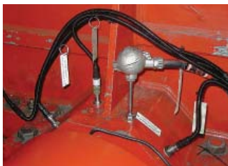
Ein typisches Beispiel für die Montage von Sensoren an einer Maschine.
