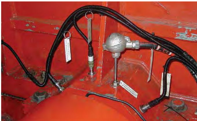
Ein typisches Beispiel für die Montage von Sensoren an einer Maschine.
